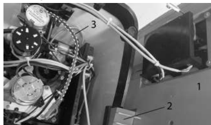
Abb. 15: LAN-Kabel durch Rückwand geführt
