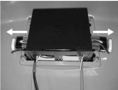
Abb. 12: Blockbatterien für die Notstromfunktion
